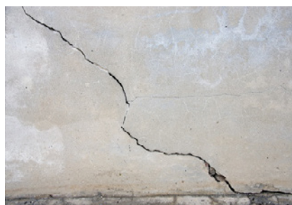
Verputzte Wand mit Rissen
